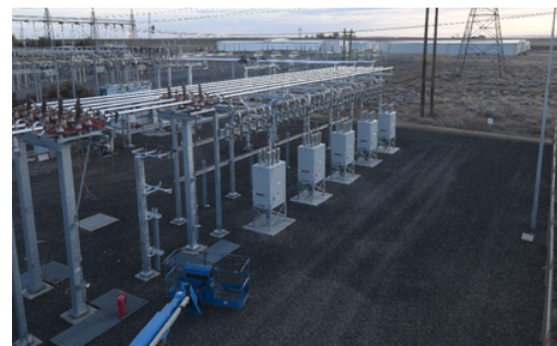
Parte del bus de lado bajo de la subestación Franklin ampliado con alimentadores adicionales.
